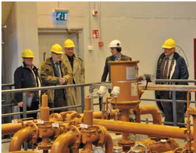
Biopolttolaitoksessa kiinnosti uusi polttotekniikka.
